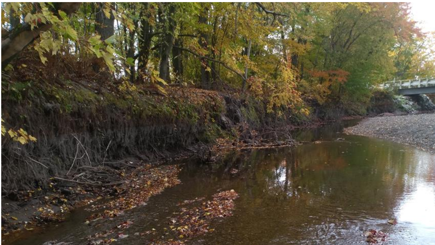
Photo 3 : Décrochement dans le sous-bassin versant de la rivière Larochelle, le 28 septembre 2020.
