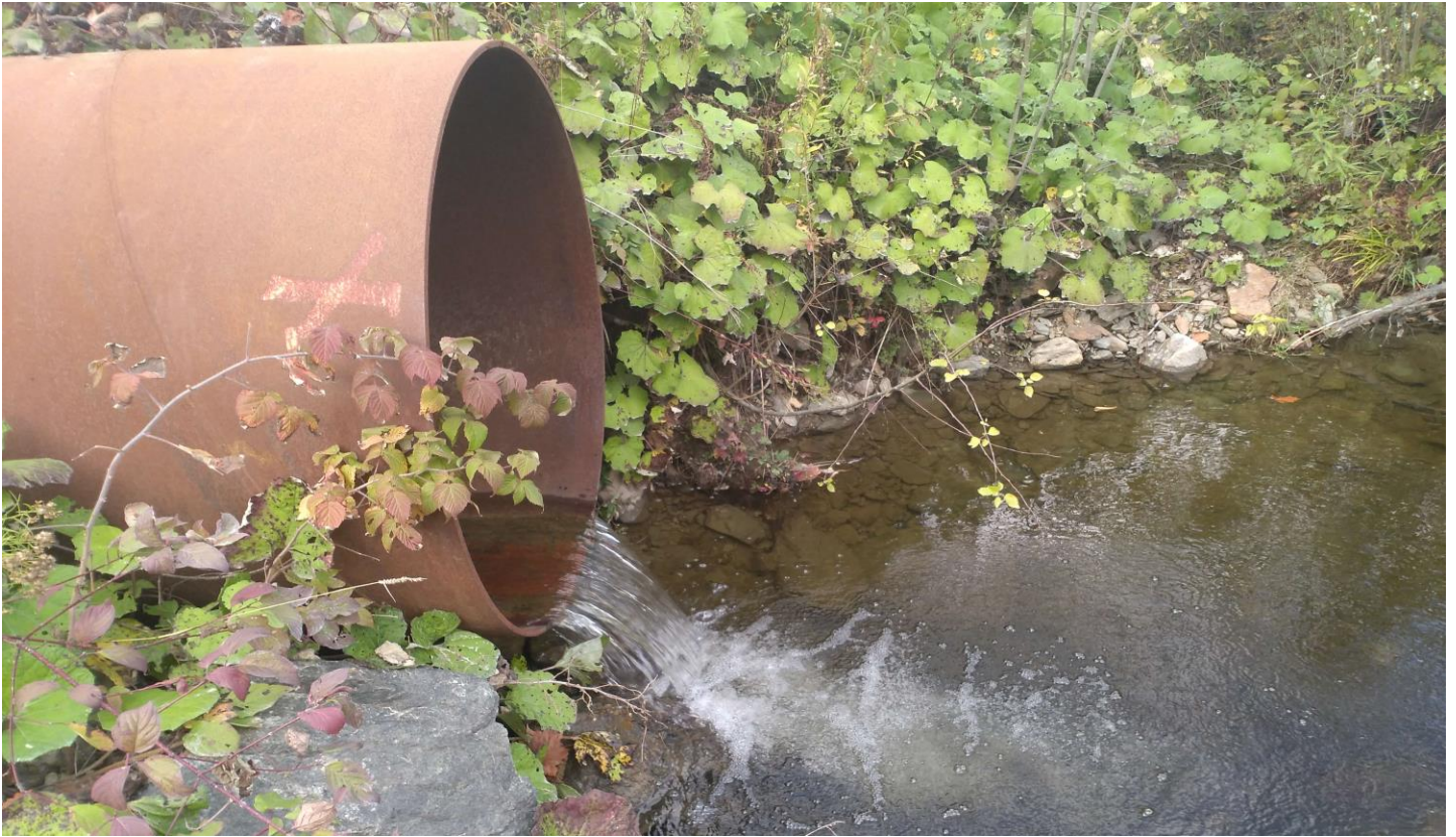
Photo 13 : Ponceau non conforme dans le sous-bassin du ruisseau Sasseville, le 1 er octobre 2020.
