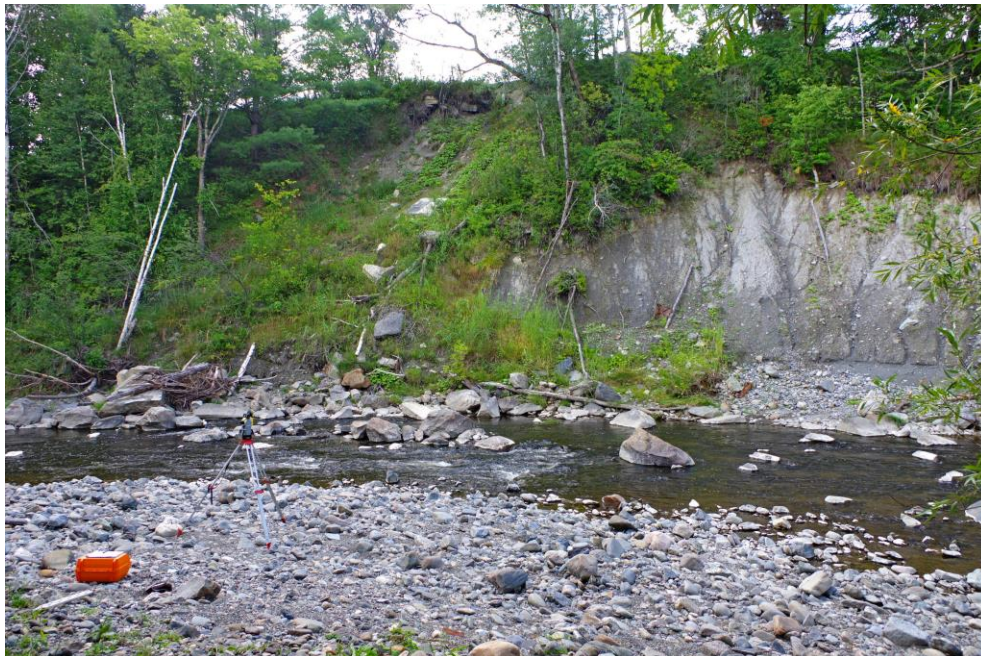
Photo 3 Vue de la partie aval de la zone érodée.
