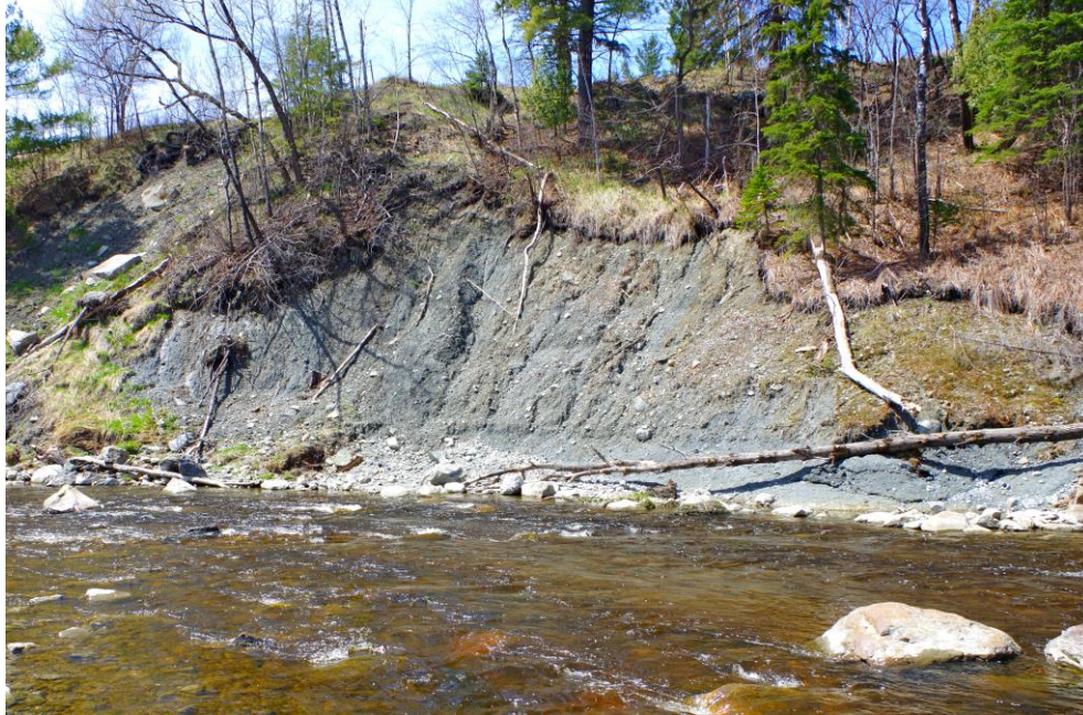
Photo 2 Vue de l'amont du site d'érosion. On remarque une forte sollicitation de la rive et le déracinement des végétaux.
